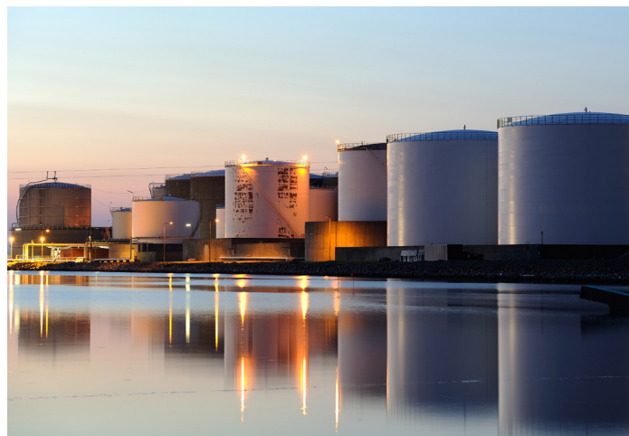
LNG & LPG Storage Tanks
